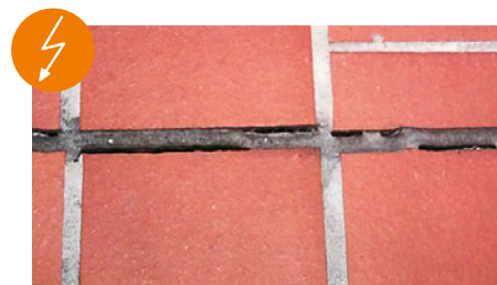
No šādiem defektiem Jūs var izvairīties, izmantojot DILEX deformācijas šuvju profilus
